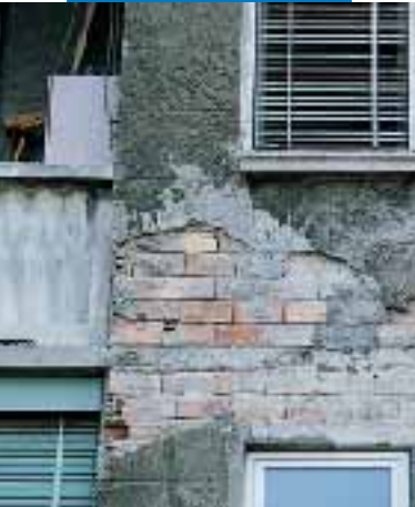
Budynek wymagający interwencji naprawczej
