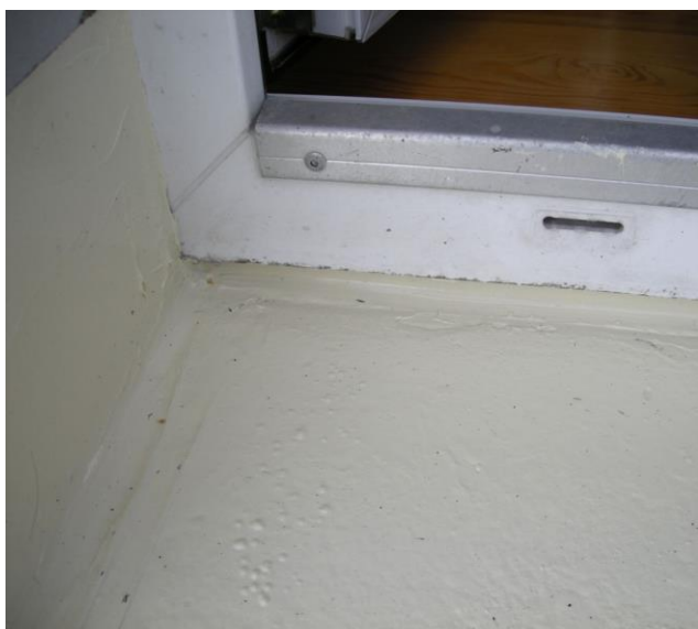
Izolacja na łączeniu drzwi balkonowych
