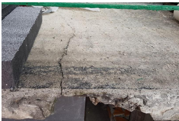
Ubytek dolnej części płyty balkonowej
