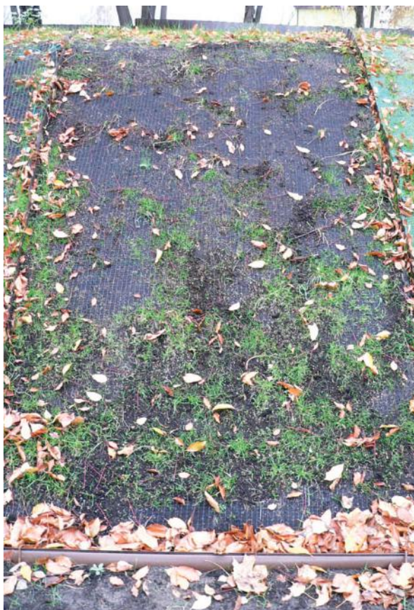
Rys. 89. Grunt spłynął z górnej części geomaty z poletka nr 7 (Fot. B. Gajewska)
