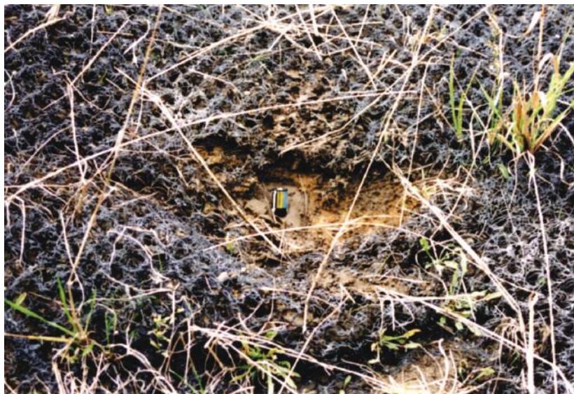
Rys. 23. Geomata VHVD uszkodzona w trakcie montażu lub w wyniku punktowego obciążenia (fot. B. Gajewska)
