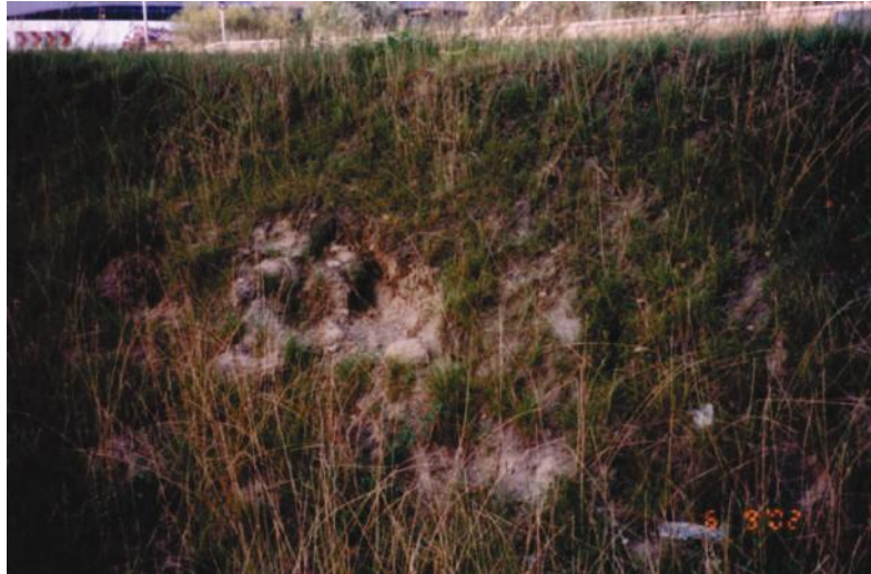
Rys. 11. Skarpa w pobliżu budowli 1 niezabezpieczona przed erozją (fot. B. Gajewska)
