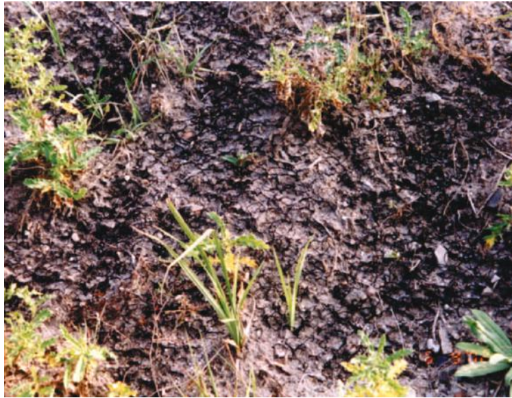
Rys. 9. Roślinność porastająca skarpe południową budowli 1 (fot. B. Gajewska)
