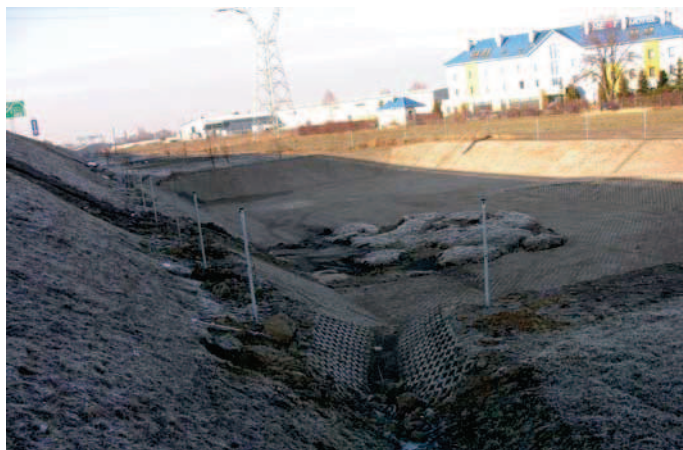
Fot. 1. Przykład osuwiska powstałego wskutek erozji żłobinowej
