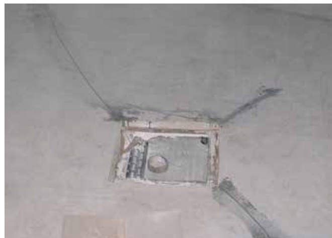
Powstawanie rys skurczowych w trakcie schnięcia na jastrychu anhydrytowym.
