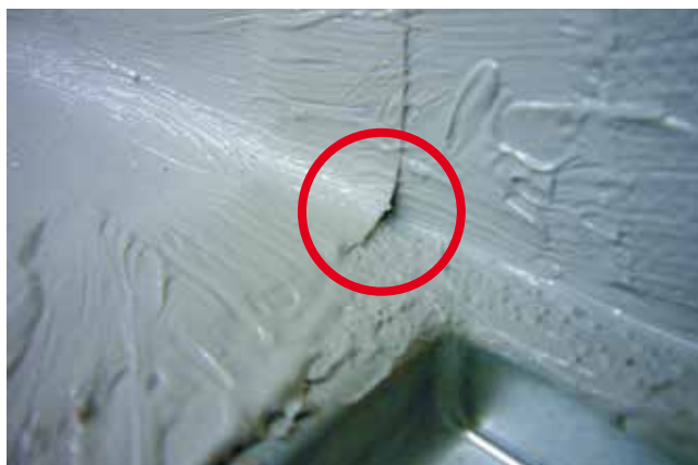
Widoczna nieszczelność w narożu.
