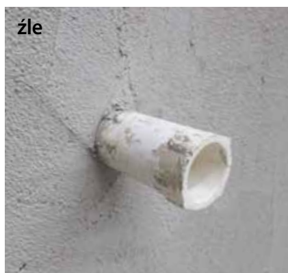
źle Otynkowane wyjście rury, którego nie można fachowo uszczelnić.
