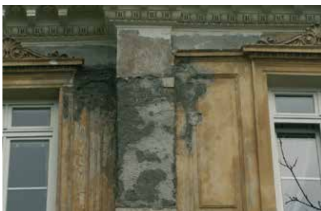
Skutki działania wody z pękniętej rury spustowej.
