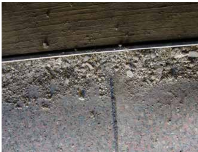
Mostek akustyczny powstały w wyniku braku ciągłości pomiędzy dwiema płytami izolacyjnymi (szczelina wypełniona zaprawą).
