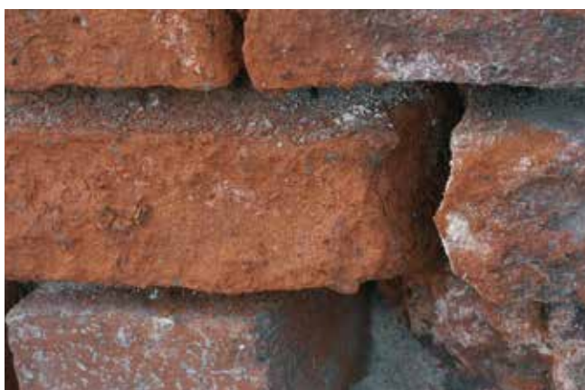
Ubytek zaprawy wapiennej w murze.
