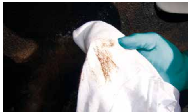
Zabarwienie brązowe: uszczelniona powierzchnia rozpuszcza się. Z dużym prawdopodobieństwem jest to powłoka bitumiczna. Po oczyszczeniu (usunięcie zabrudzeń i ziemi) powierzchnię poddać renowacji bitumiczną masą uszczelniającą np. Sopro KSP 652 lub Sopro KD 754 .
