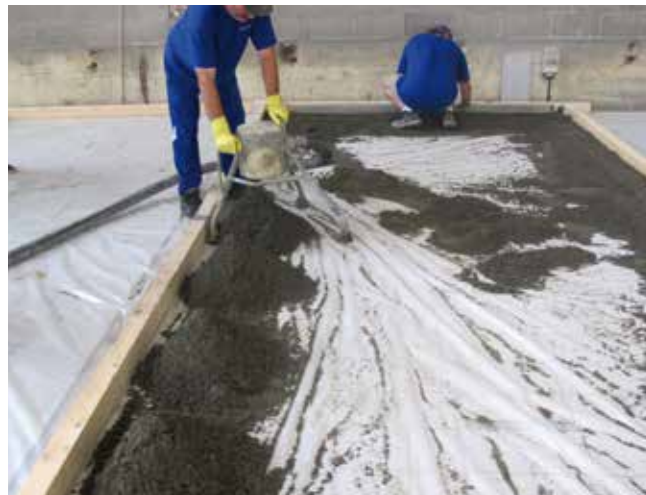
Zaprawa jastrychowa naniesiona na podkład z folii i zagęszczona. Jastrych nie ma trwałego połączenia z podłożem.
