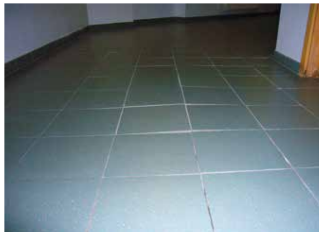
Spuchnięty jastrych anhydrytowy po zalaniu wodą.
