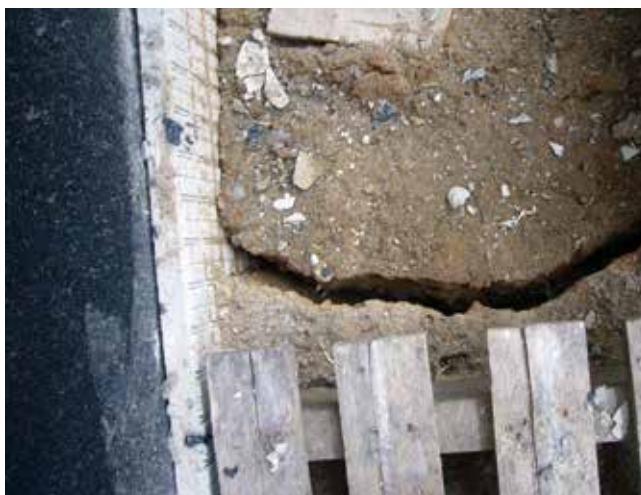
Znaczne osiadanie gruntu z powodu niewystarczającego zagęszczenia wypełnienia wykopu. Brak warstwy poślizgowej doprowadził do uszkodzenia uszczelnienia.
