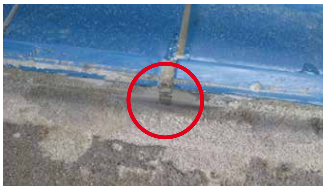
Wypływ wody przez spoinę rynny przelewowej.
