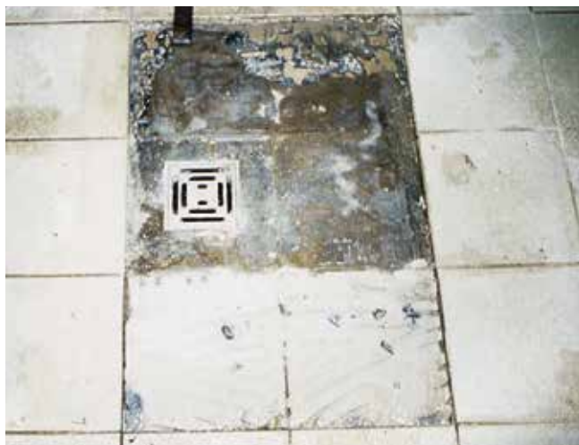
Brak uszczelnienia w okolicy wpustu podłogowego.
