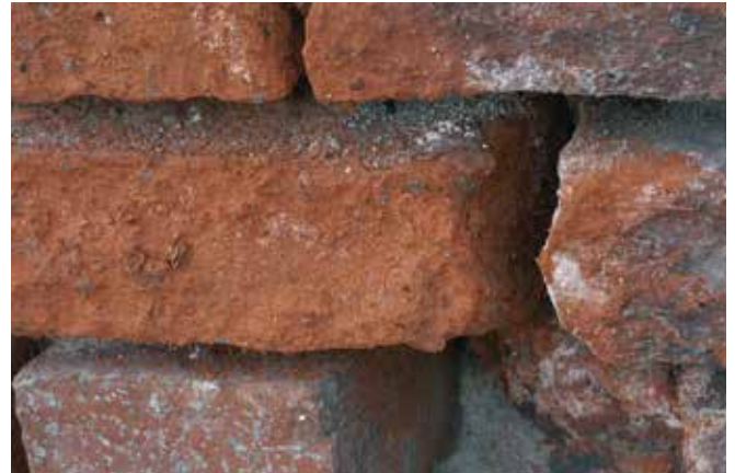
Zniszczona powierzchnia cegły i wypłukana zaprawa.
