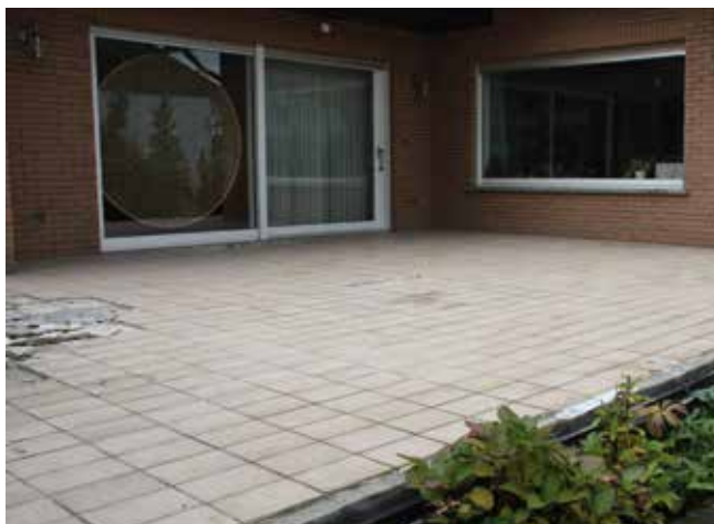
1 Stara, nośna okładzina ceramiczna na tarasie.
