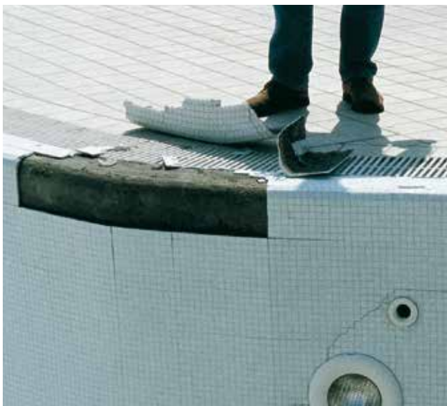
Utrata przyczepności w obszarze reflektora.
