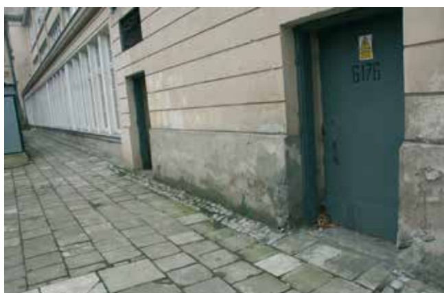
Niewłaściwe ukształtowanie spadków.
