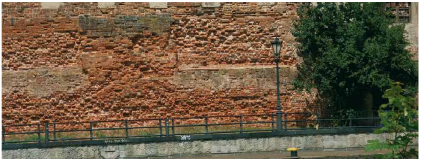
Zniszczony mur wskutek długotrwałego działania wody.
