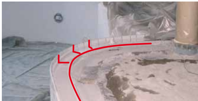
Półokrągła nieszkała z uszkodzoną rynną przelewową.
