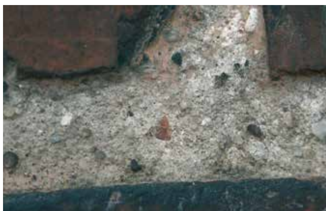
Cegła i zaprawa przed czyszczeniem i renowacją.
