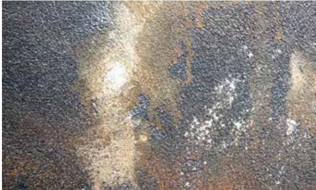
Stare, odsłonięte uszczelnienie piwnicy.
