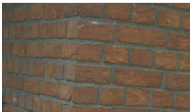
Powierzchnia muru poddana renowacji.
