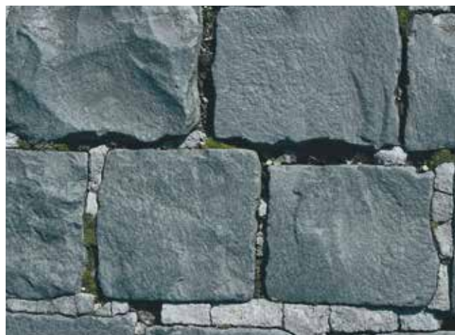
Zniszczona fuga jako efekt kombinacji hydraulicznie wiążącej fugi i elastycznego podłoża przy wysokich obciążeniach użytkowych.
