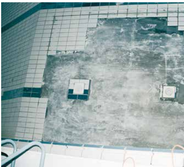
Utrata przyczepności spowodowana zbyt cienką warstwą uszczelnienia.
