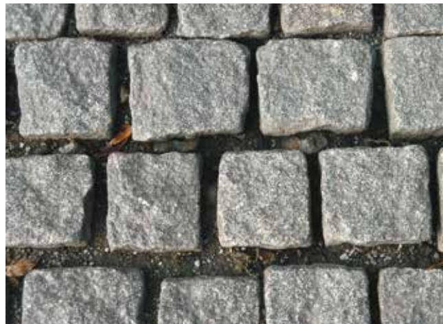
Wypłukane wypełnienie na skutek czyszczenia mechanicznego i działania wody opadowej.
