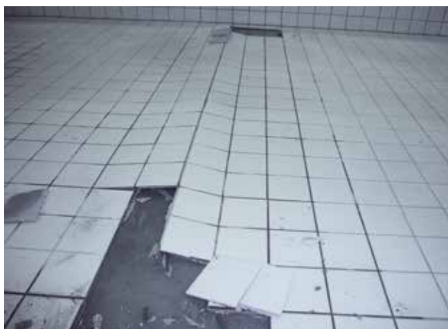
Odspojenia okładziny na dnie niecki.
