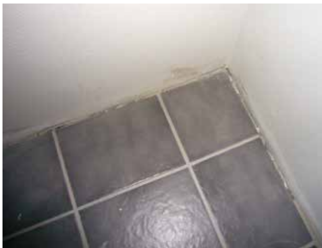
Mostek akustyczny powstały z powodu braku taśm dylatacji brzegowej.
