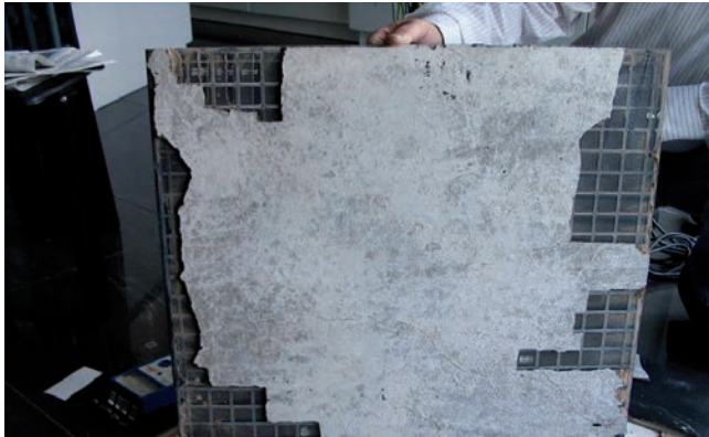
Odspojenie okładziny wraz z warstwą osłabionego jastrychu.
