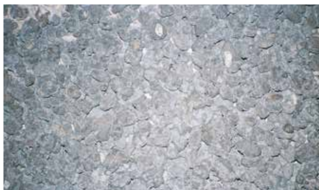
Porowaty jastrych cementowy z otwartymi porami.
