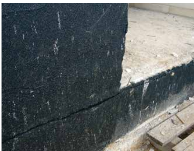
Zerwanie uszczelnienia z powodu braku warstwy poślizgowej pomiędzy uszczelnieniem a osiadającym gruntem.
