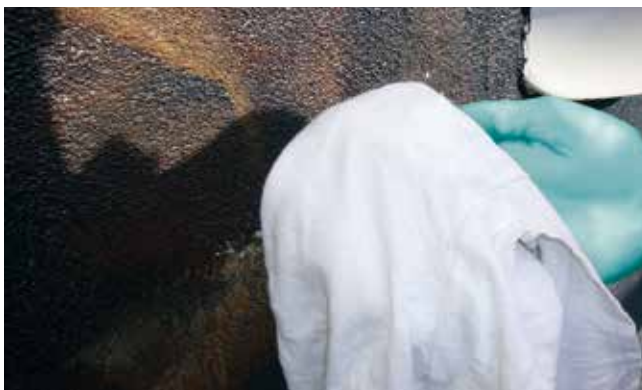
Brak zabarwienia: próba nie wykazała częściowego rozpuszczenia się starej powłoki. Z dużym prawdopodobieństwem jest to powłoka smołowa.
