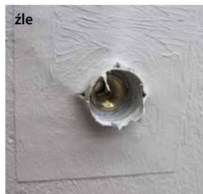
źle Po odkręceniu korka do zamontowania instalacji uszczelka całkowicie utraciła właściwości uszczelniające.
