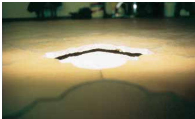
Pustki pod okładziną ceramiczną.
