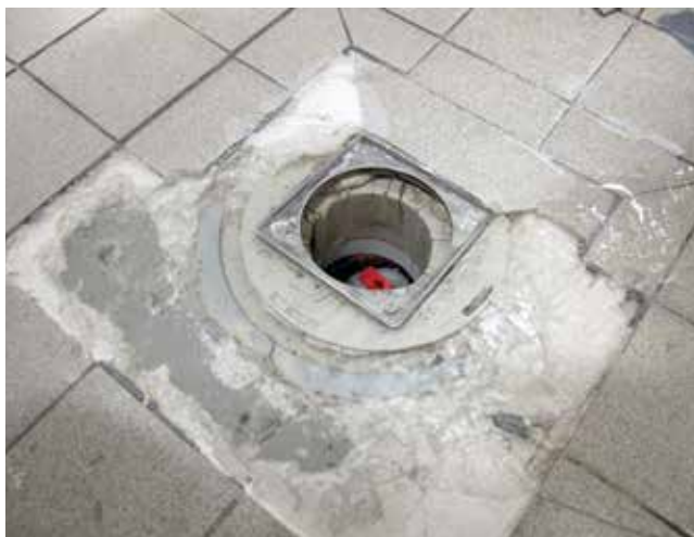
Fabrycznie zamontowany kołnierz uszczelniający został odcięty. W konsekwencji brak możliwości poprawnego wklejenia uszczelki podłogowej na zaprawie uszczelniającej.
