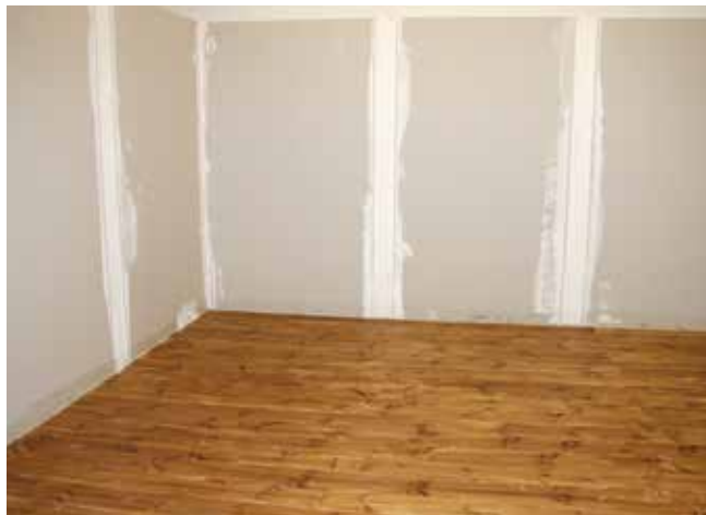
1 Płytki zostaną ułożone na niestabilnym podłożu drewnianym.
