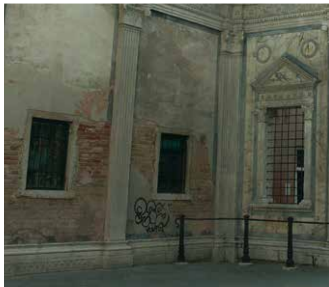
Brak izolacji poziomej.
