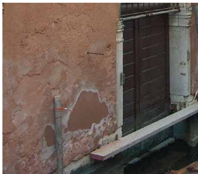
Skutki długotrwałego działania wody.
