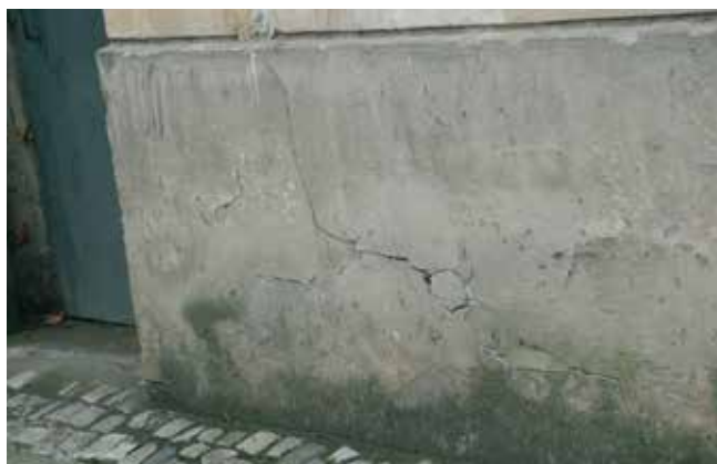
Cokół budynku przed renowacją.
