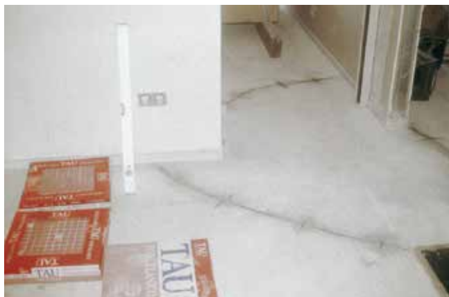
Tworzenie się rys po wyschnięciu jastrychu anhydrytowego z powodu braku dylatacji dzielącej powierzchnię posadzki na pola oraz w obszarze drzwi.
