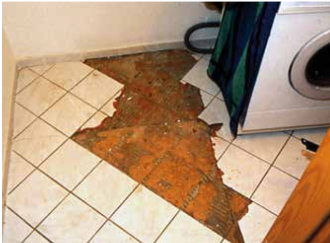
Pęknięcia w okładzinie w obszarze styku płyt wiórowych, spowodowane przez drgania (np. pralki).
