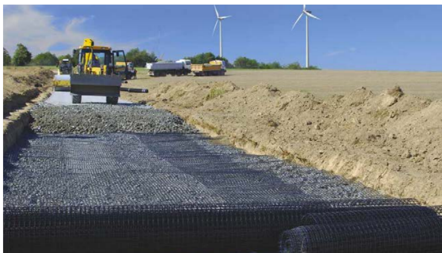
📍 Głubczyce (woj. opolskie) 📄 Budowa dróg technologicznych i dojazdowych do farmy wiatrowej, placów montażowych oraz platform roboczych 🧺 Polgrid 30/30 200.000 m 2
