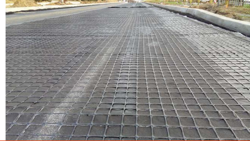
📍 Kalisz (woj. wielkopolskie) 📄 Przebudowa drogi i wzmocnienie warstwy bitumicznej 🔲 PolGrid FSR BX20/20 150PP 14.400 m 2
