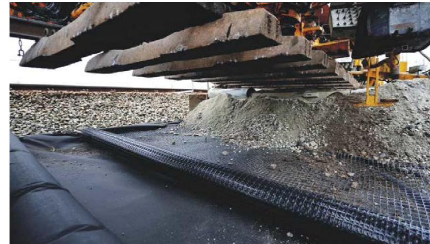
📍 Brzezinka Średzka (woj. dolnośląskie) 📄 Zbrojenie warstwy ochronnej torowiska 🧺 Polgrid BX 30/30 oraz geotkanina separacyjna 7.000 m 2
