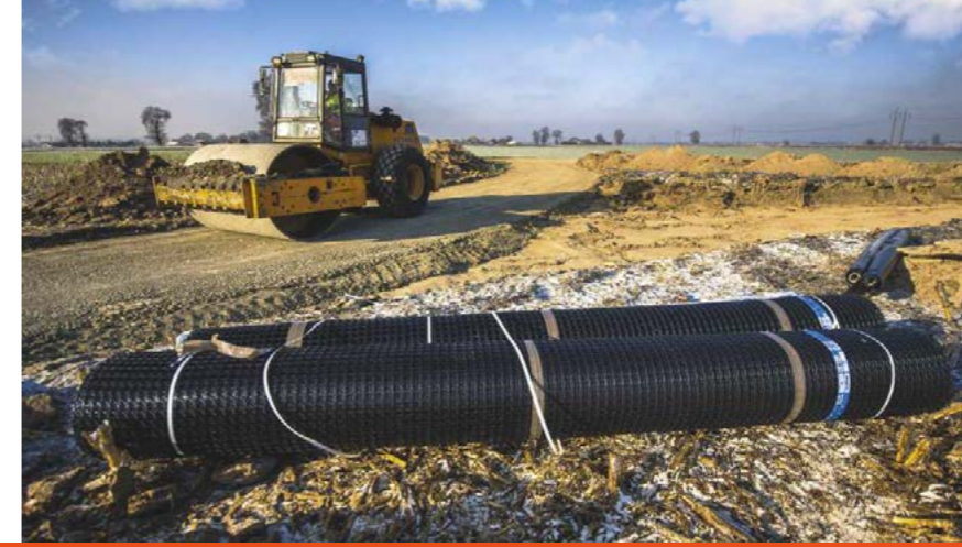
📍 Inczew (woj. łódzkie) 📄 Budowa dróg technologicznych i dojazdowych do farmy wiatrowej, placów montażowych oraz platform roboczych 🧺 Polgrid 30/30 180.000 m 2
